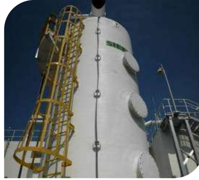
Filtro Biológico Percolador (BTF)
